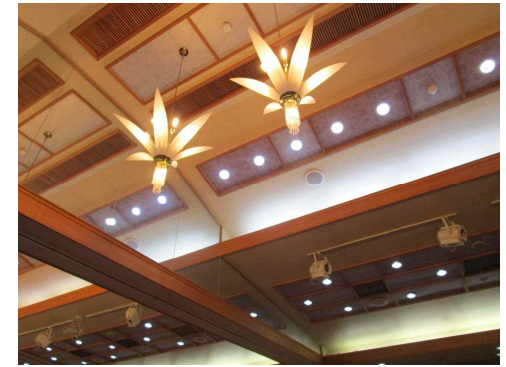
施設照明のLED化
